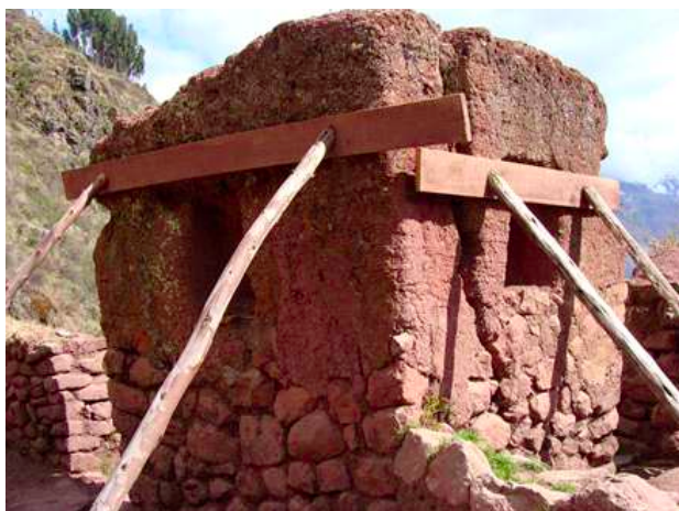
Figura 9. Muros de adobe deteriorados por la intemperie
