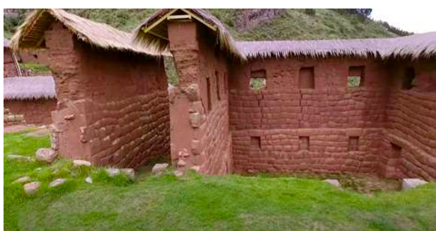
Figura 21. Recinto 1 y 2 subsector D, intervención realizada con cobertura de protección sobre los muros
