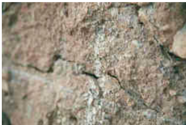
Figura 16. Fisura en el fragmento de barro ocasionado por fuerzas mecánicas del muro
