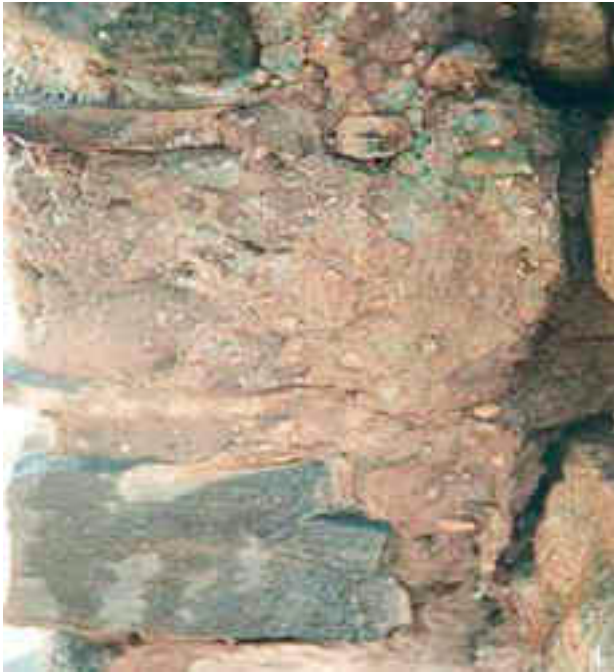
Figura 9. Fragmento pequeño de revoque ubicado en la parte del vano del recinto
