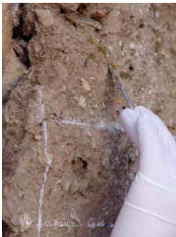
Figura 12. Revoque de barro con presencia de líquenes
