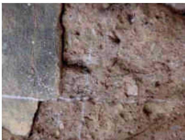
Figura 11. Revoque de barro con alteraciones físicas
